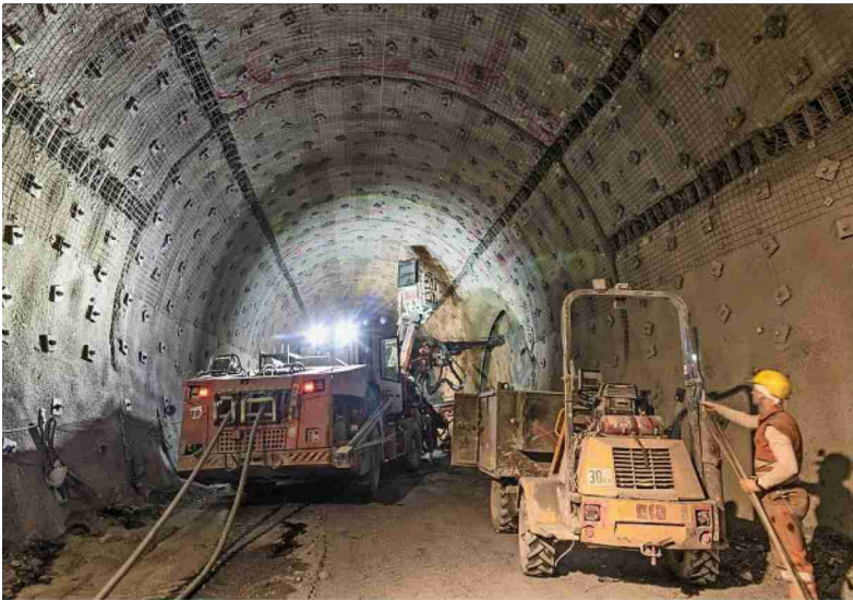
Arbeiten für den Semmering-Basistunnel im Osten Österreichs: Die Marti-Gruppe erstellt den Abschnitt Grautschenhof (rot) Foto: Imago
