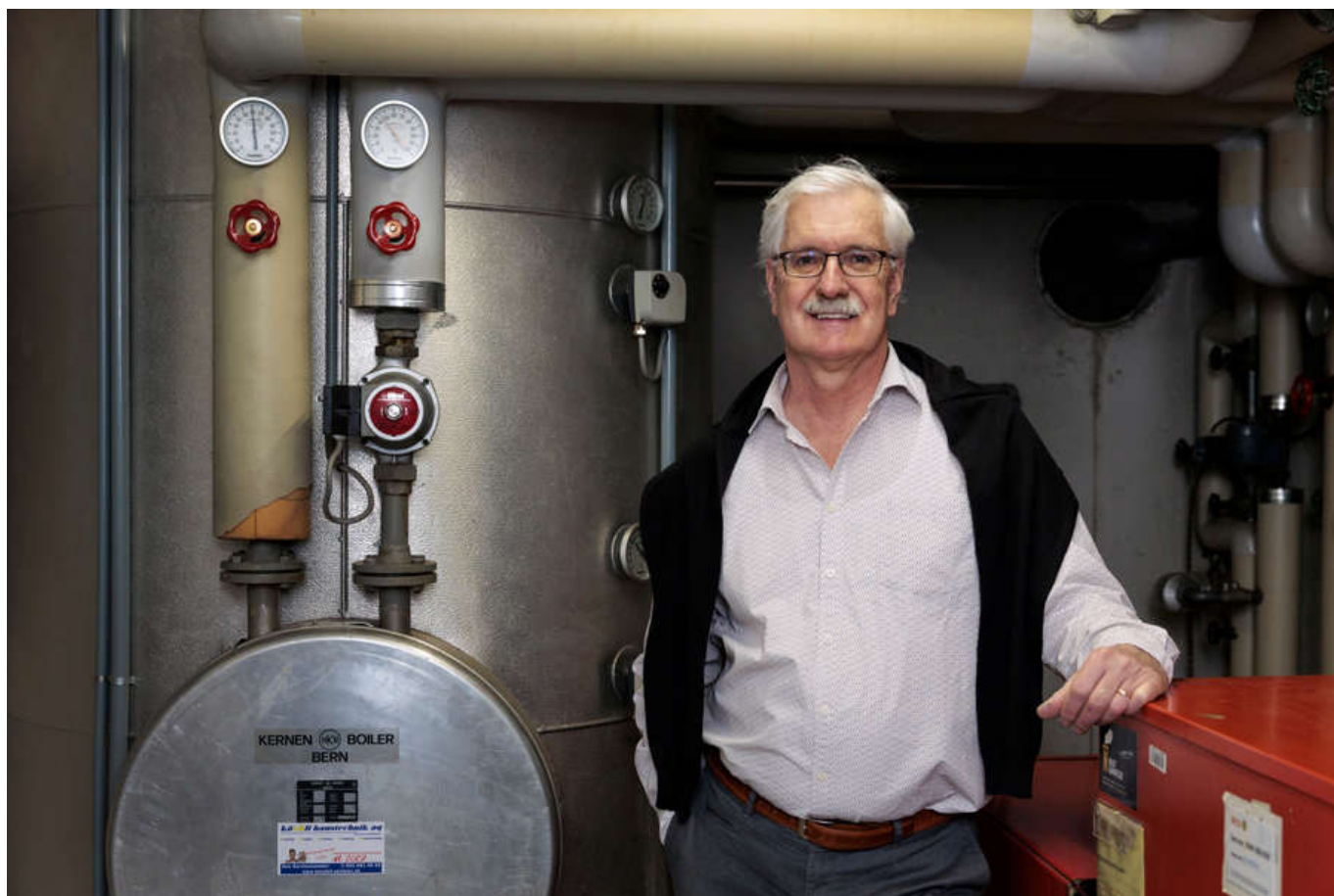
Warmwasserboiler sollen tagsüber mit Solarstrom aufgeladen werden, fordert Roland Lüthi, GLP-Grossrat und Leiter einer Haustechnikfirma. Foto: Christian Pfander
